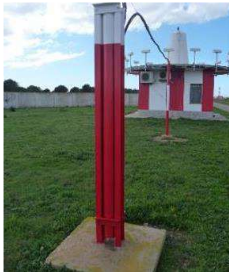
Figura 2. Acometida aérea de la antena DME existente conectada mediante un poster intermedio. Fuente: PPT del expediente.
