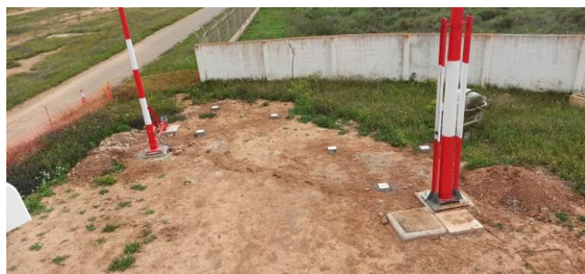
Antena DME, pararrayos y arquetas
