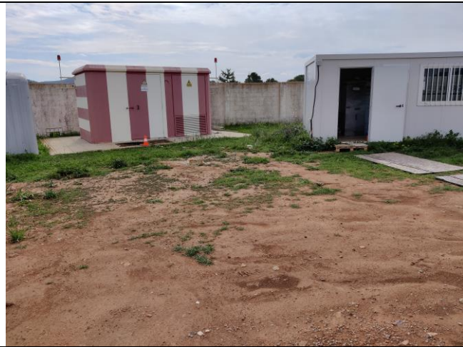
Centro de transformación y caseta de obra
