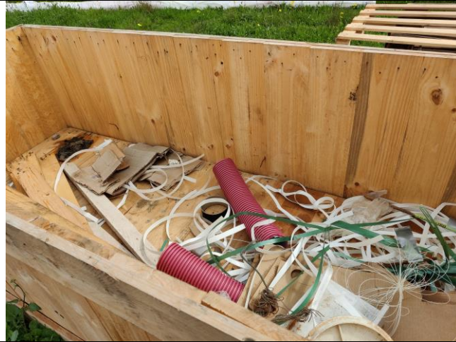
Contenedor de residuos.
