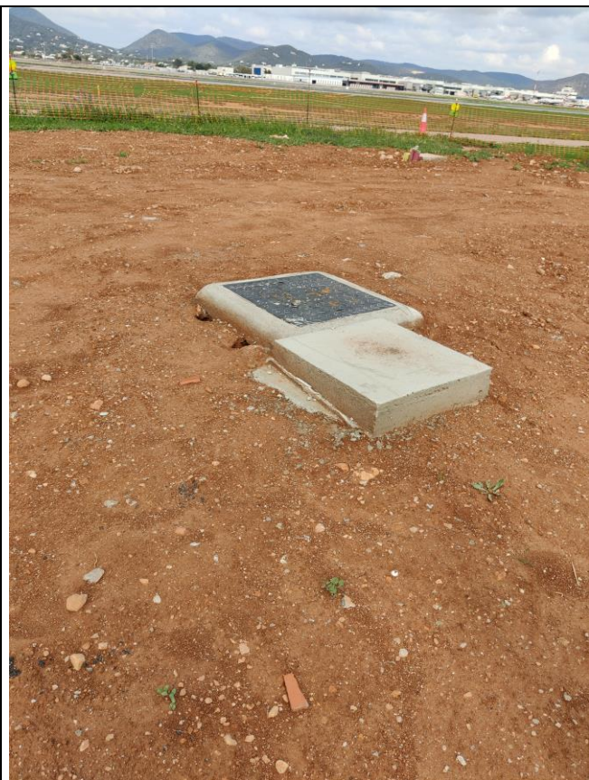
Arqueta y base del pararrayos
