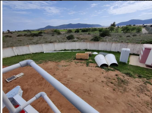
Emplazamiento de la obra. Muro que separa la obra del espacio natural protegido. Acopio del pararrayos y radomo. Contenedor de residuos.
